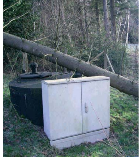
Der Elektroschrank wurde verschont.
