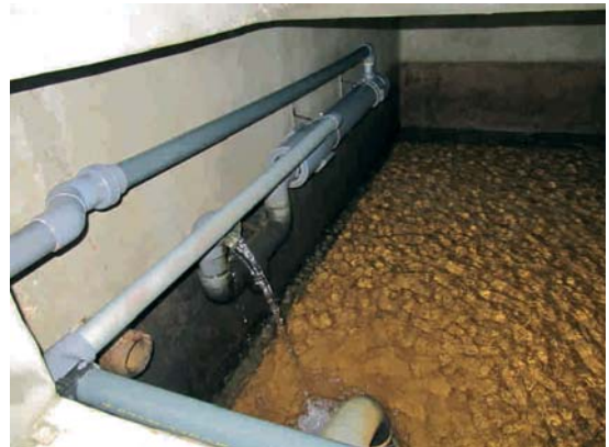
Der Sammelbehälter dient als Vorstufe der Filteranlage. Nach physikalischer Belüftung erfolgt hier schon die erste Ausfällung der Schadstoffe.
