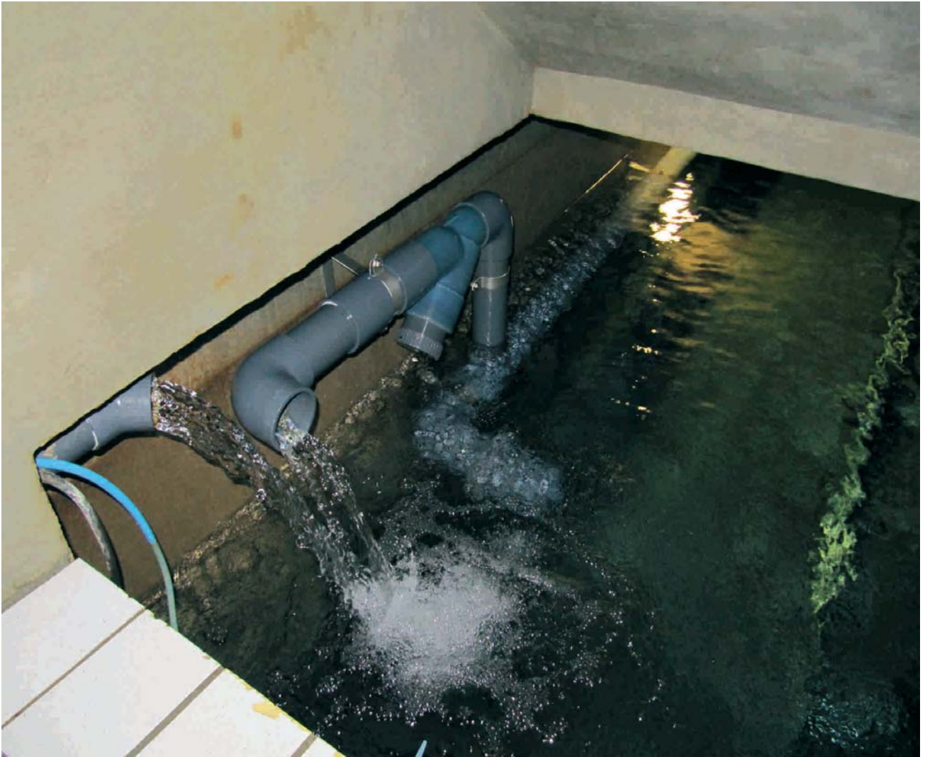
Im Sammelbehälter II werden gefiltertes und ungefiltertes Wasser gemischt. Von hier aus wird es in den Hochbehälter gepumpt.
